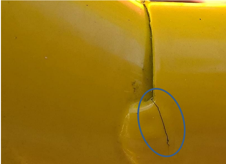
Microfissure au travers du cordon de soudure
